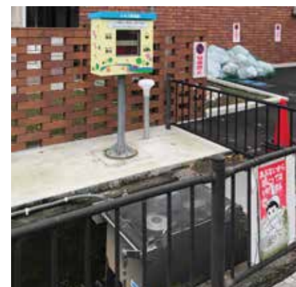
桃井小学校の正門脇にEV充電器用の発電機が設置されています。ここで発電した電気は、同校の外灯の一部に使用されています。すぐ近くには計量表示板があり、発電量と累積発電量が一目でわかります
